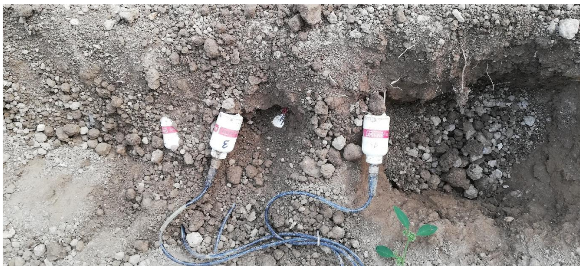
Slika 15. Nepravilno vgrajeni merilci vode v tleh
